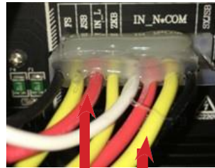
Кабель водяного насоса
