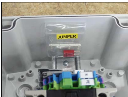
Перемычка и заглушка в электромонтажной коробке.
