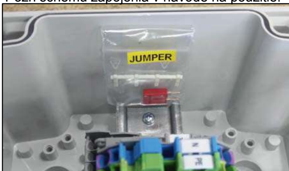
Pribalený mostík a záslepka v rozvodnej krabici
