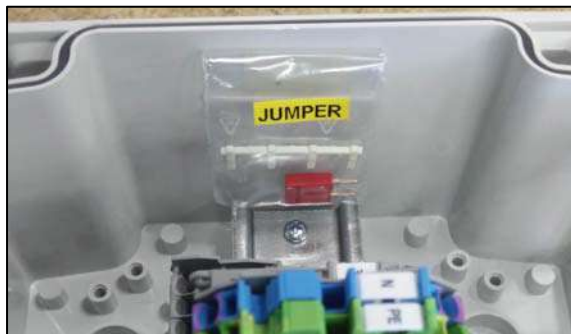
Переключатель и заглушка в электроустановочной коробке
